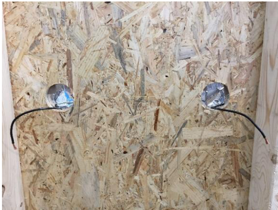
Abbildung 5: Hintere Planke mit Löchern für die Kabeldurchführungen
